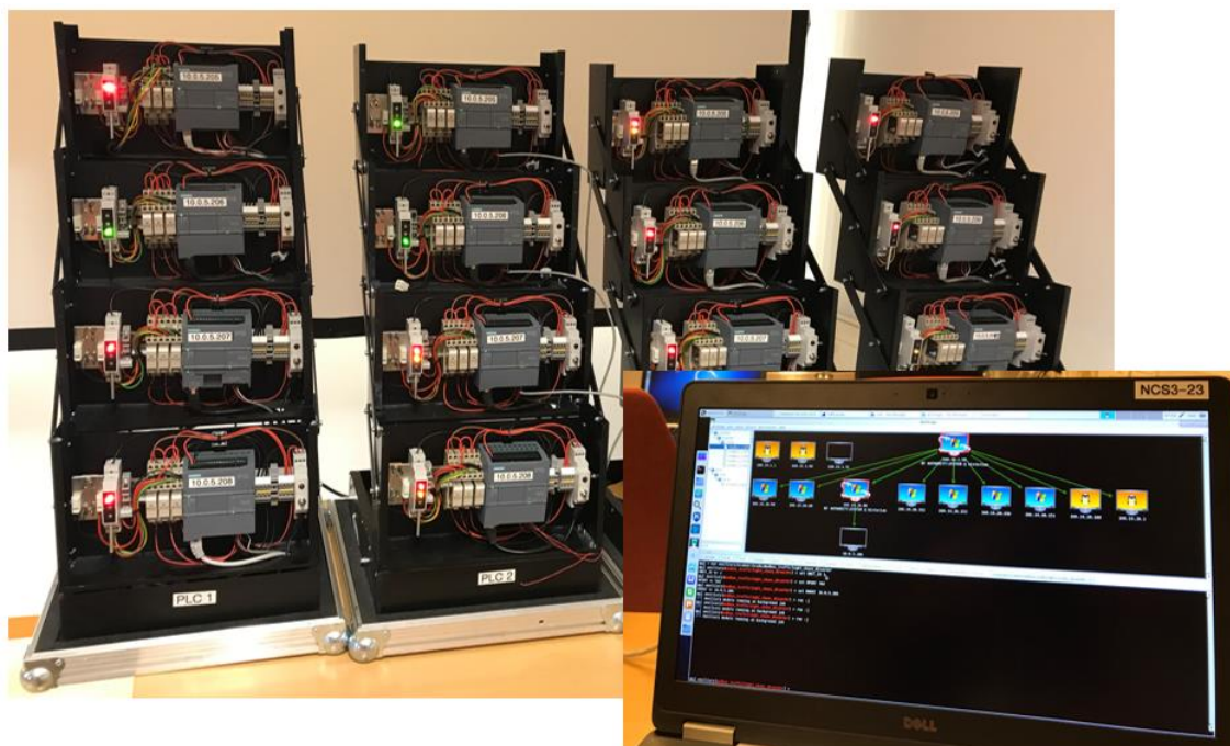
Figur 2: Trafikljusmiljön används under grundkursens laborationer där varje deltagare har en egen instans av övningsmiljön och ett eget ”trafikljus” som styrs av en PLC. Figuren visar också gränssnittet i Armitage som används under laborationen.
